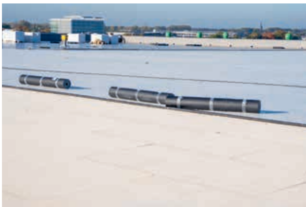
BATIBOARD toegepast op een logistiek centrum in Veghel.
